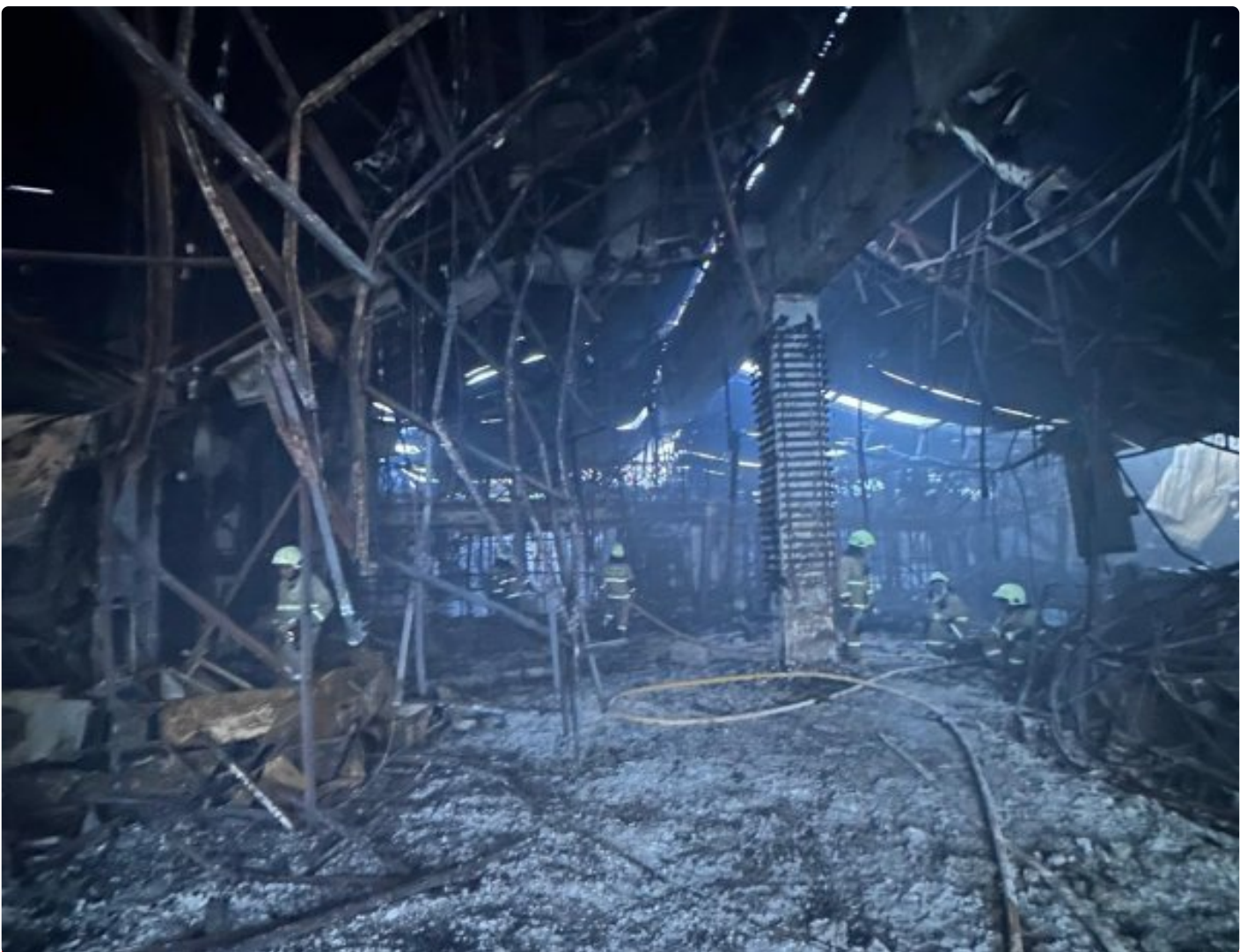
Glodok Plaza yang Hangus Terbakar
